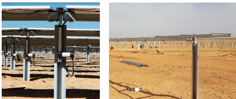
Figura 6 - Particolare strutture ad inseguimento ed attuatore
