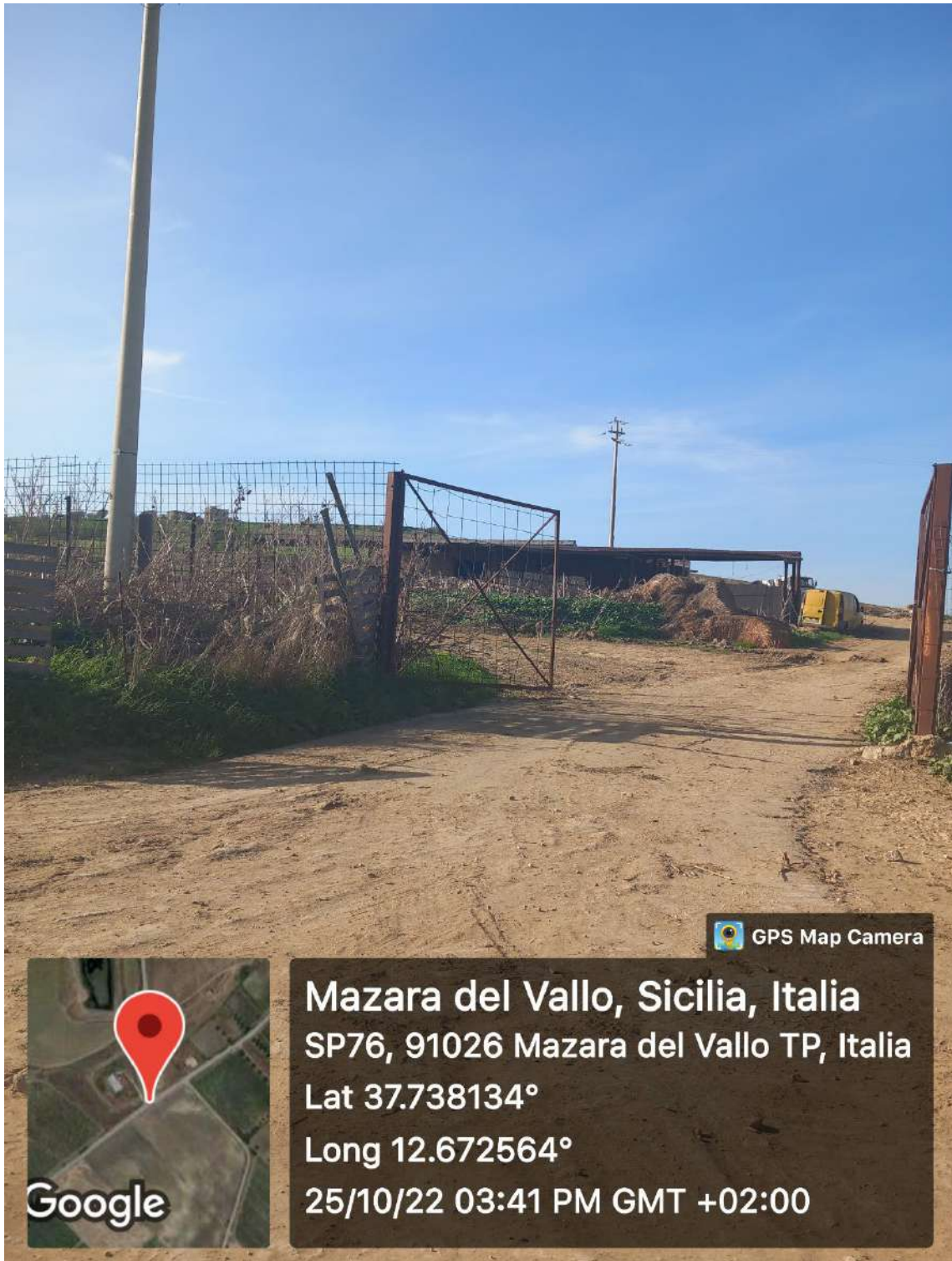
Cavidotto su strada non identificata
