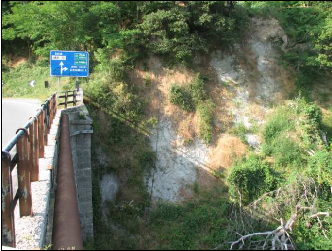
Erosione dei versanti in sinistra del T.Lemme
