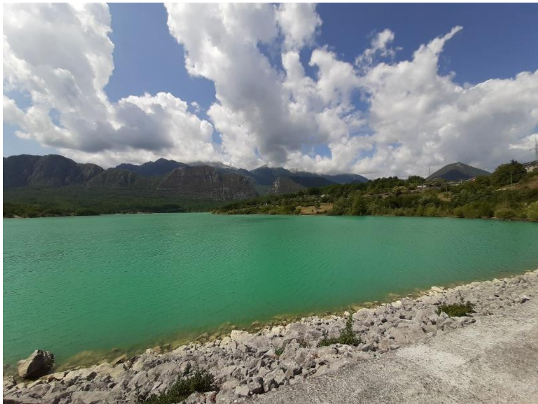
Figura 4-13 - Diga di Castel San Vincenzo. Monitoraggio delle misure di collimazione. La superficie della protezione di monte appare irregolare e disordinata
