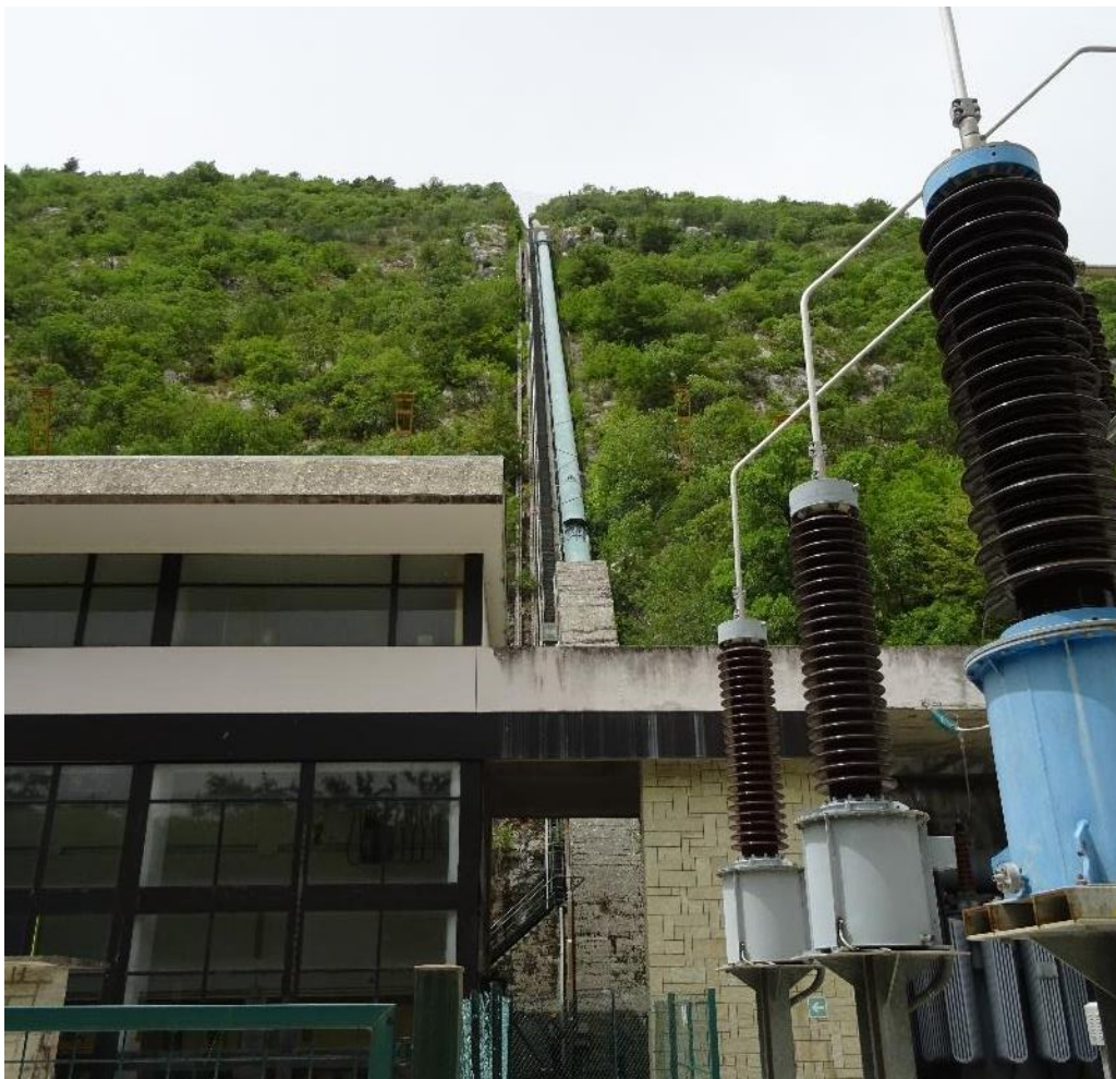
Figura 2-2: Vista della condotta forzata dal piazzale della Centrale di Pizzone
