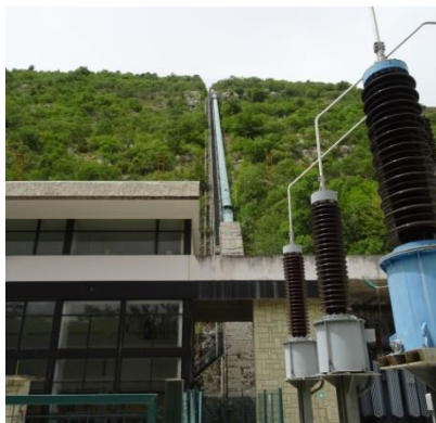
Figura 2-7. Vista della condotta forzata dal piazzale della Centrale di Pizzone
