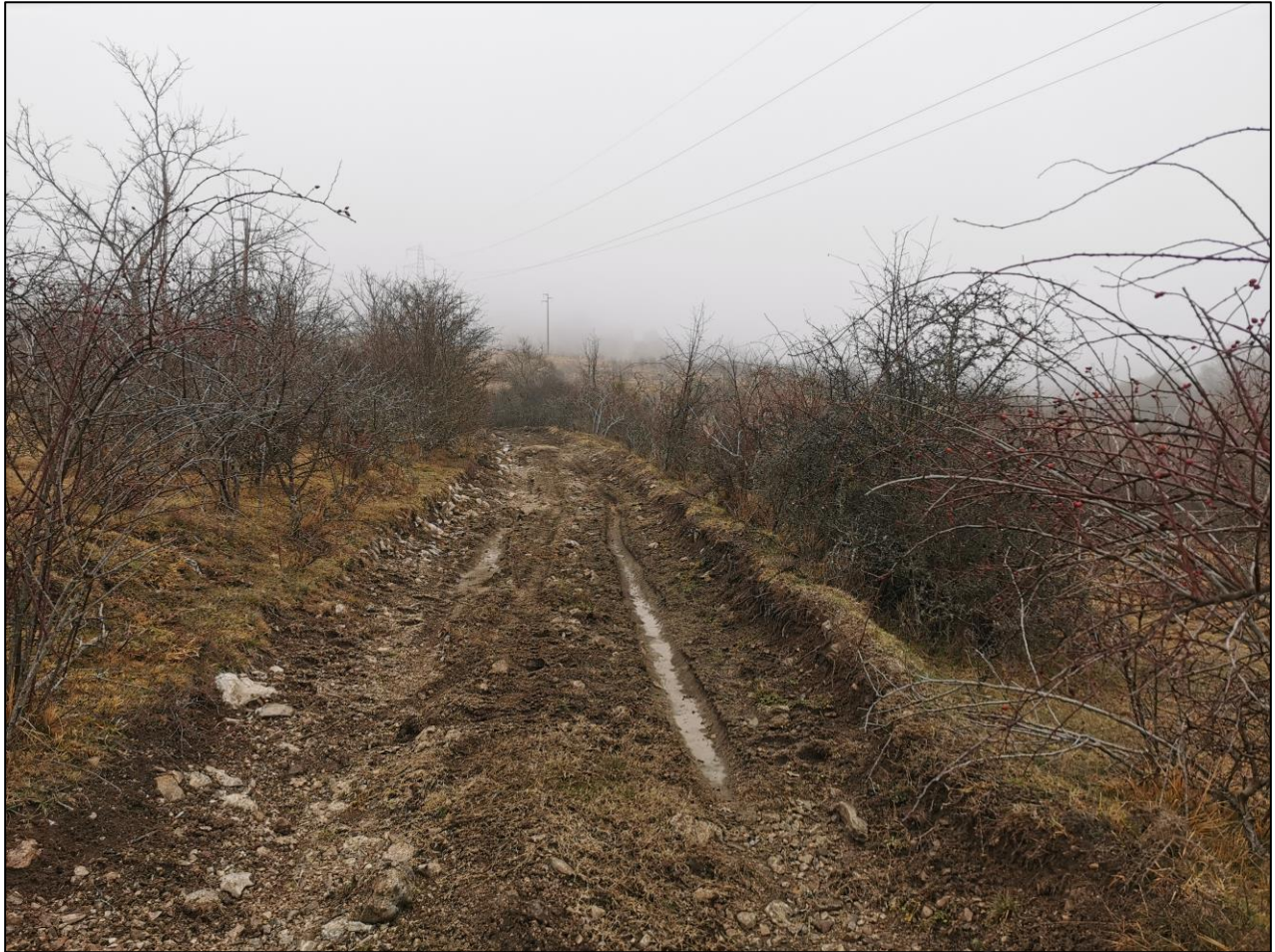
Figura 24 - Punto P18. Inquadramento dell'area interessata dalla collocazione futura della viabilità d'accesso alla stazione elettrica
