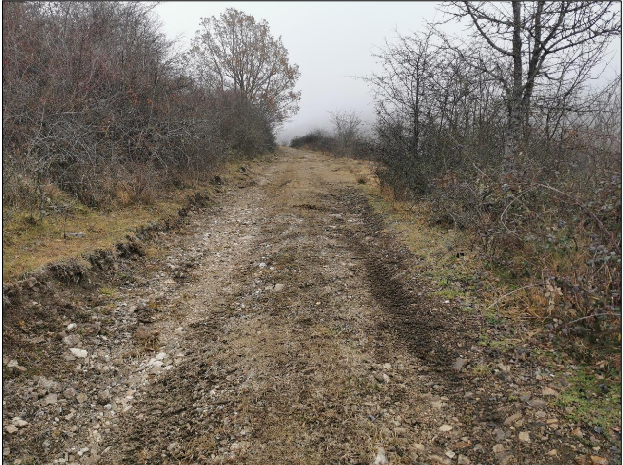
Figura 21 - Punto P16. Inquadramento dell'area interessata dalla collocazione futura della viabilità d'accesso alla stazione elettrica
