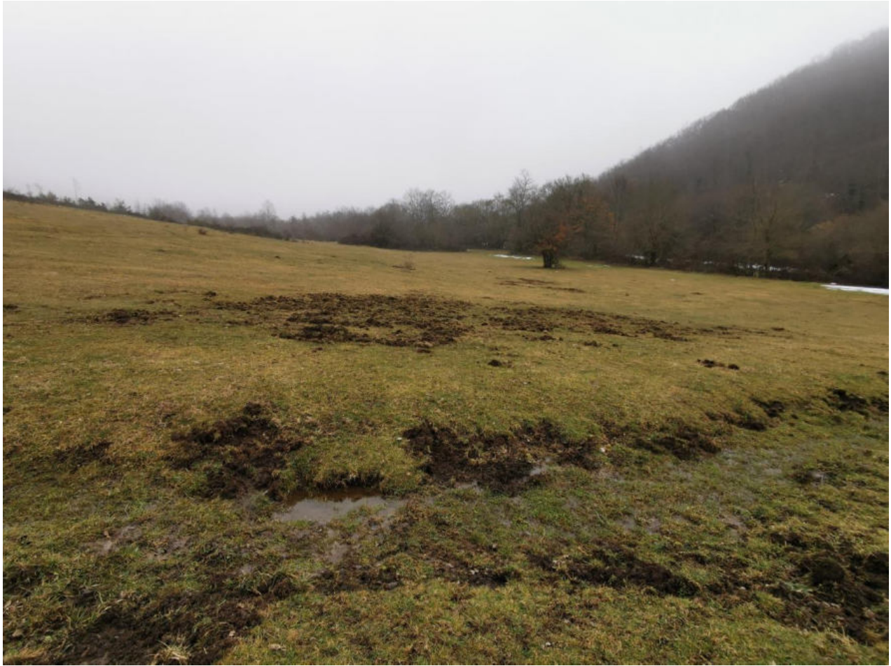
Figura 21 – PV8 Foto della nuova viabilità su prato pascolo per accesso alla futura SE
