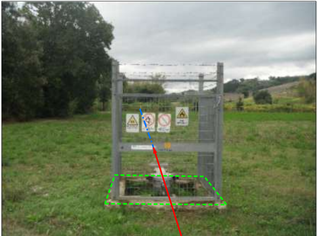
Segnapig esistente da rimuovere
