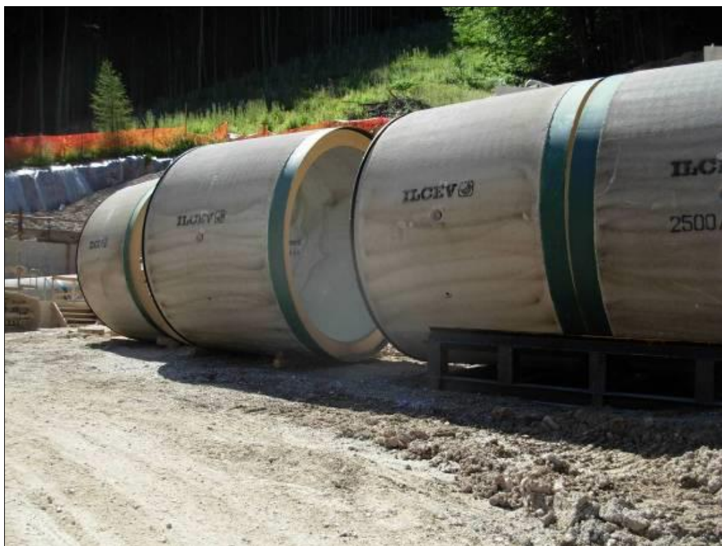
Fig. 2.8 - Stoccaggio tubi in c.a.
