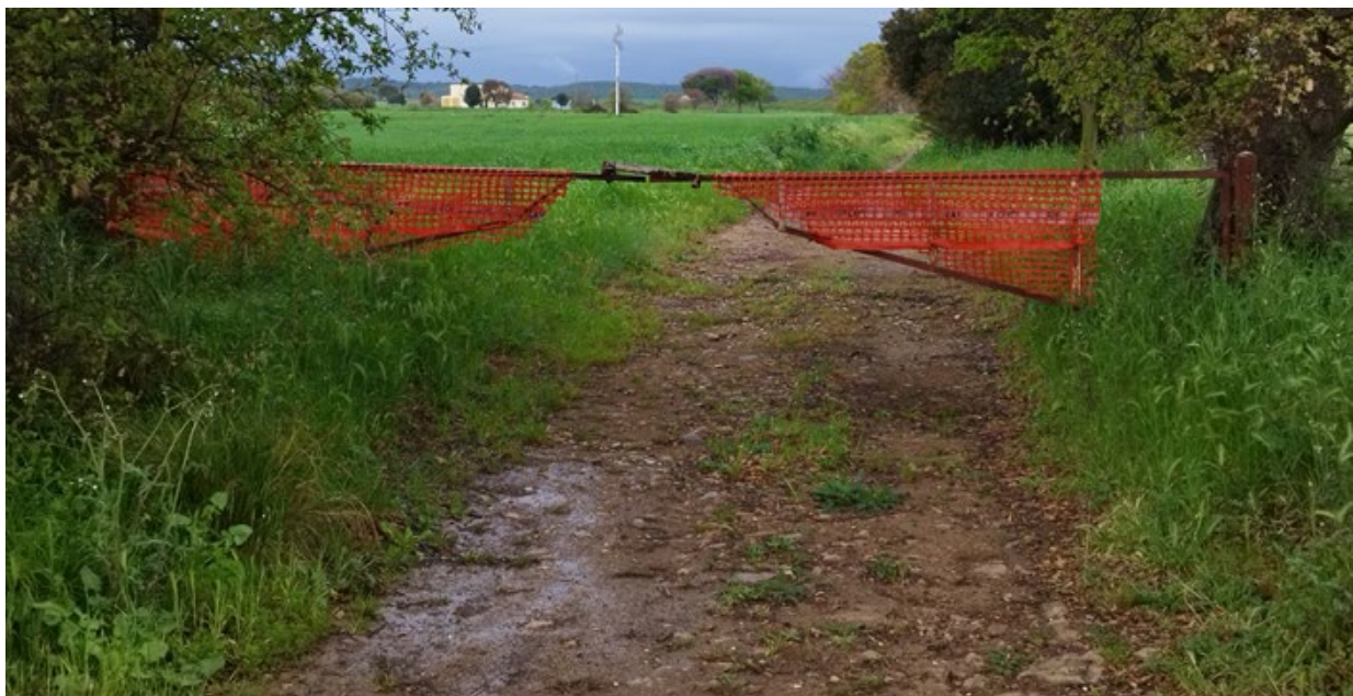
Viabilità esistente con pavimentazione naturale in pessimo stato
