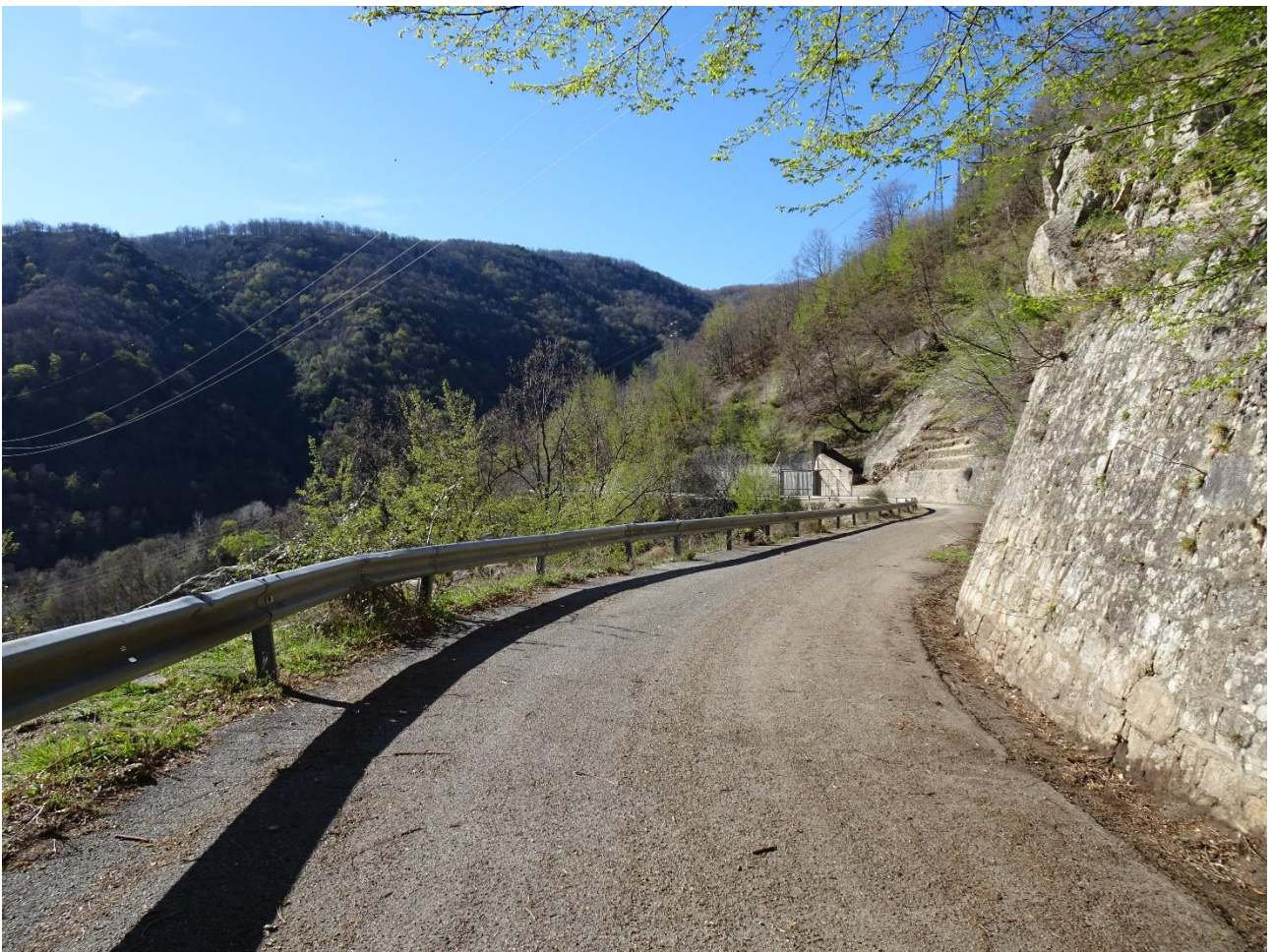
Figura 31: stato della strada in prossimità della diga di Orichella
