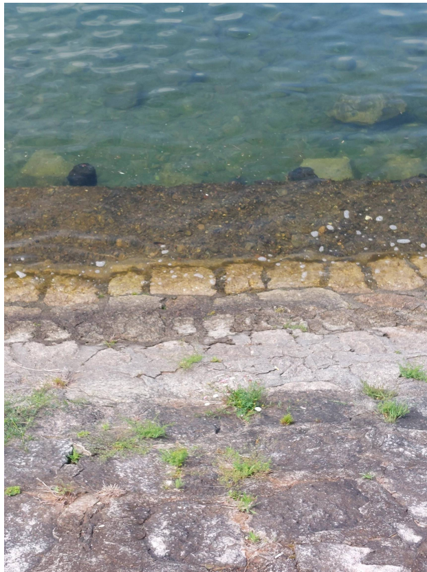
Fig. 27 – Opere di sostegno dello scivolo sottostante alla gradonata mediante pali in legno
