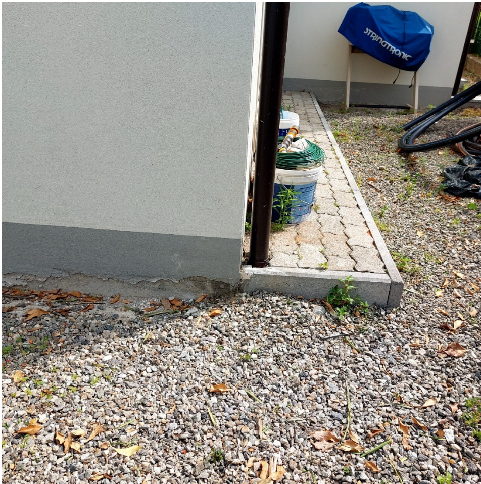
Fig. 14 – Edifici con gronde e pluviali con scarico diretto nel terreno
