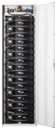
Esempio rack batterie
