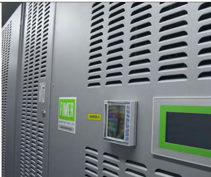
Figura 16 – foto delle Cabine elettriche
