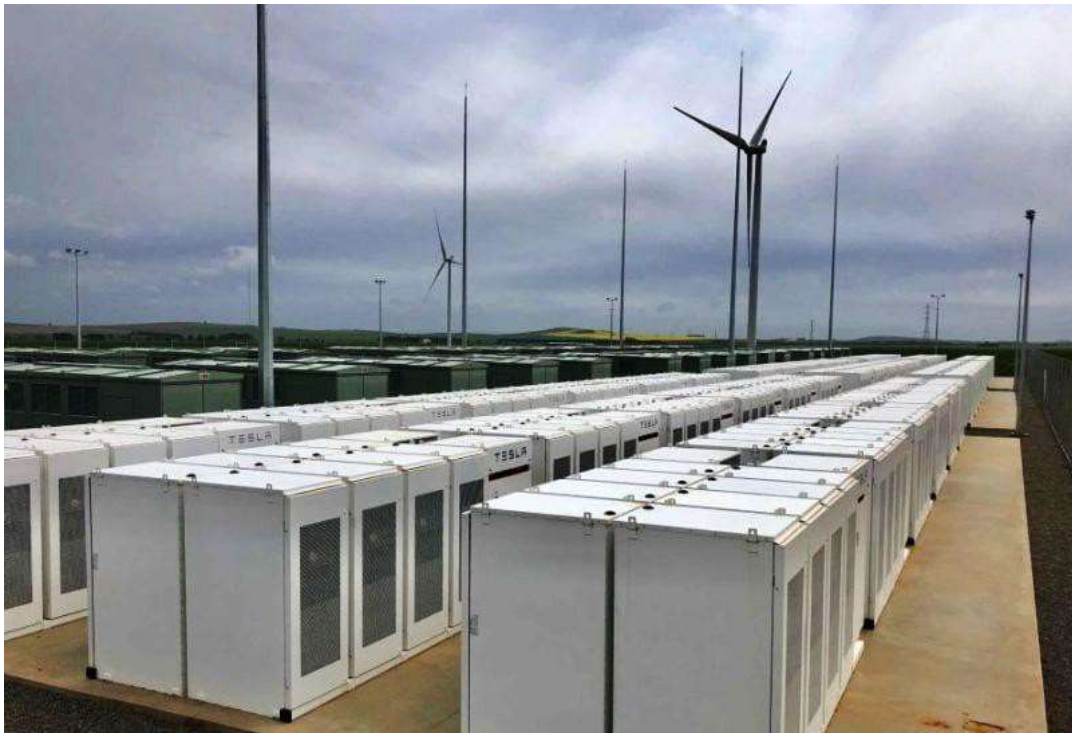
Sistema tipo di accumulo
