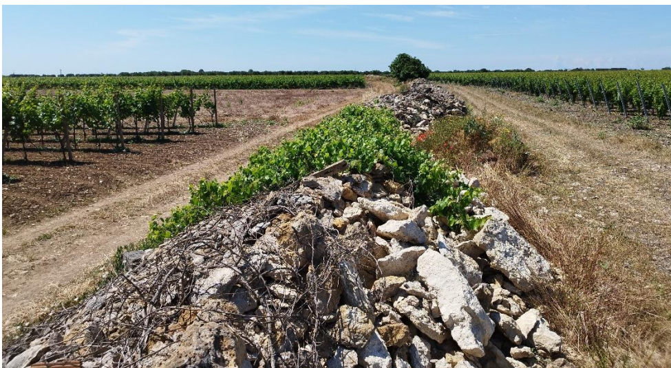
Foto 21: Muretti a secco crollati– Elementi caratteristici del paesaggio nell'intorno di 500m dall'impianto
