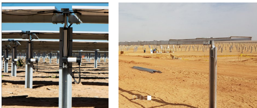
Figura 6 - Particolare strutture ad inseguimento ed attuatore
