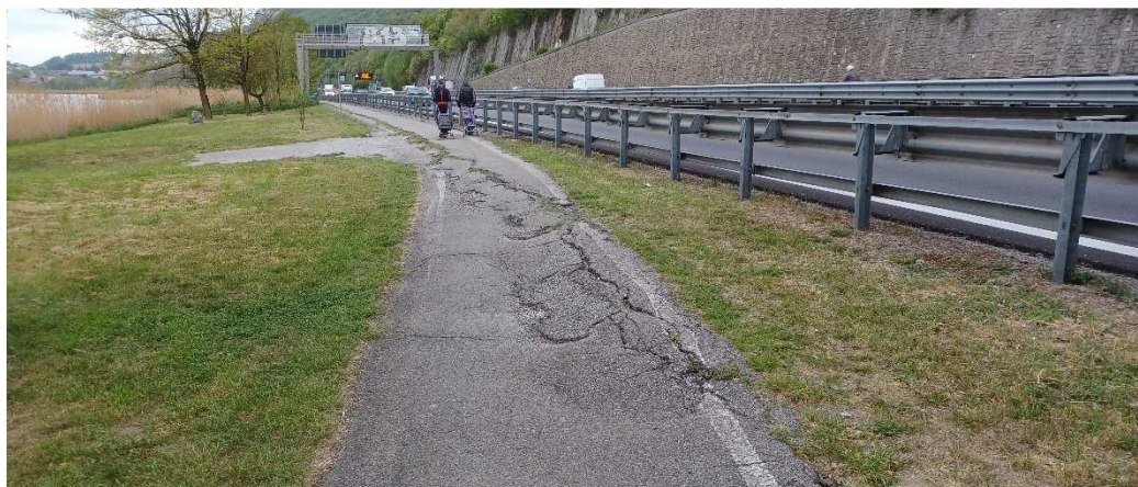
Figura 3-46 - Cedimento della pista ciclopedonale in vicinanza al rilevato della SS36..
