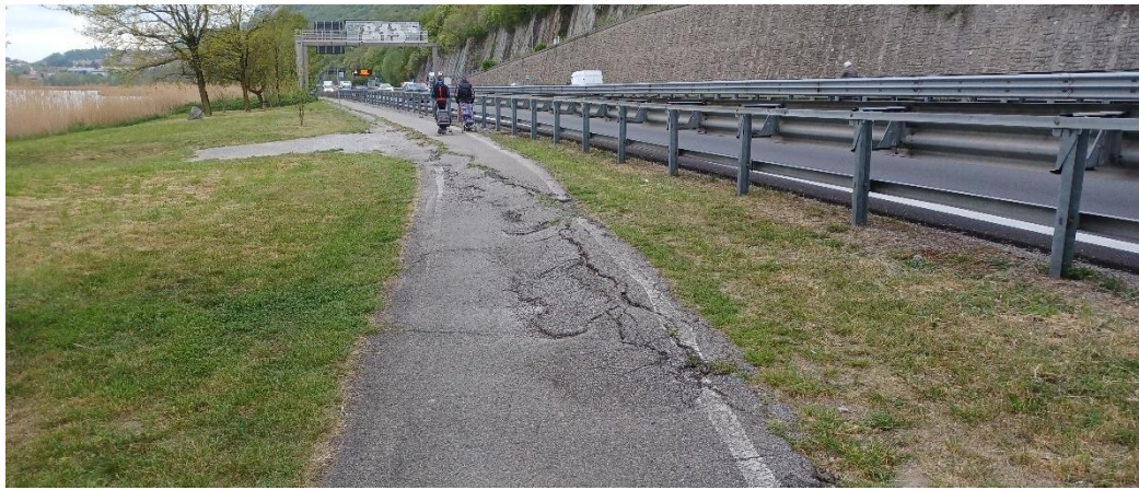
Figura 6-38: Cedimento della pista ciclopedonale in vicinanza al rilevato della SS36.
