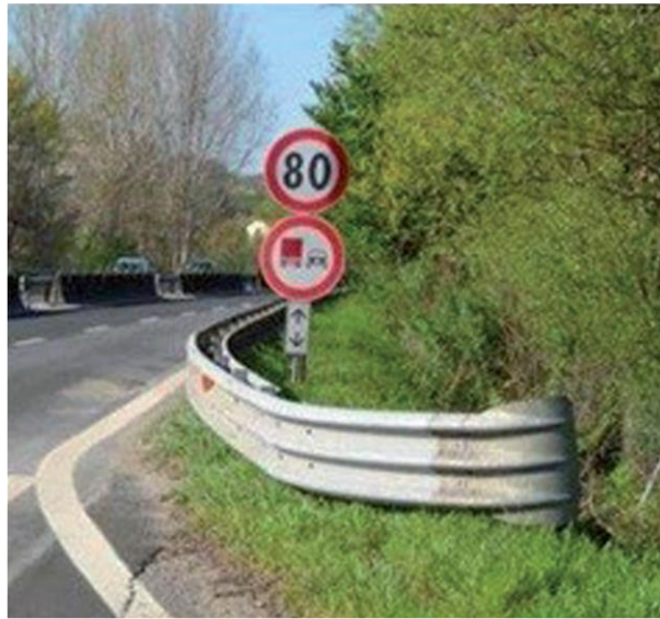
Figura 20 - Terminale semplice installato correttamente (fonte Quaderno tecnico Anas Vol. VI)
