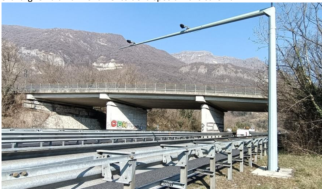
Figura 30 – Ostacolo fisso a lato della S.S. 36 km 42+600
