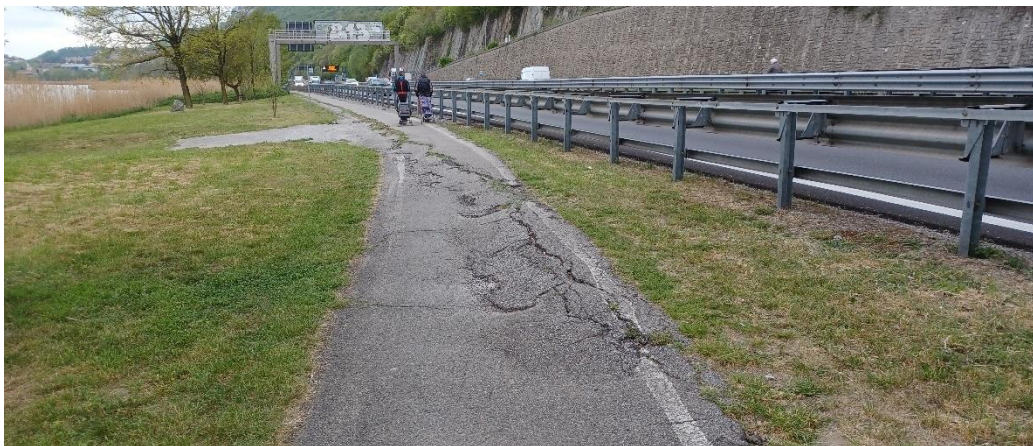
Figura 16 - Cedimento della pista ciclopedonale in vicinanza al rilevato della SS36.
