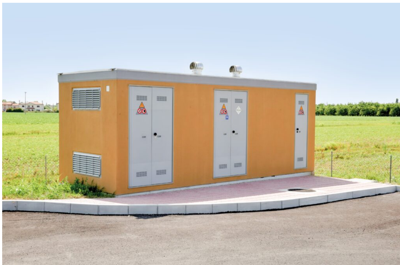
Figura – Cabina di Consegna, Utente – Esempio con posa
