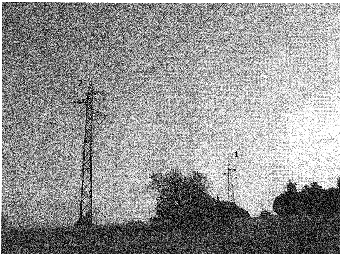
Immagine 3 – Elettrodotto 2. Flaminia – Monte Mario traliccio vista da Nord – Est. In secondo piano elettrodotto 1. Flaminia – La Storta.
