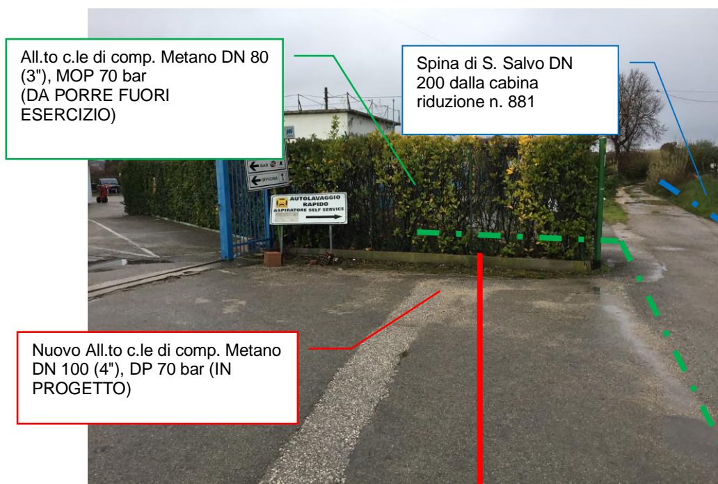
Foto n.23 – Km 2+716 - Vista metanodotti presso area di distribuzione metano
