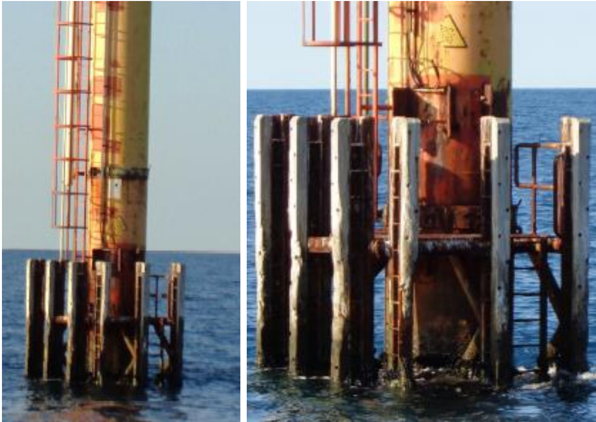
Figura 1-3: Viste generali della monotubulare e risalita delle condotte (a sinistra) e imbarcadero (a destra) Piattaforma Fabrizia 1 (fonte: Eni).
