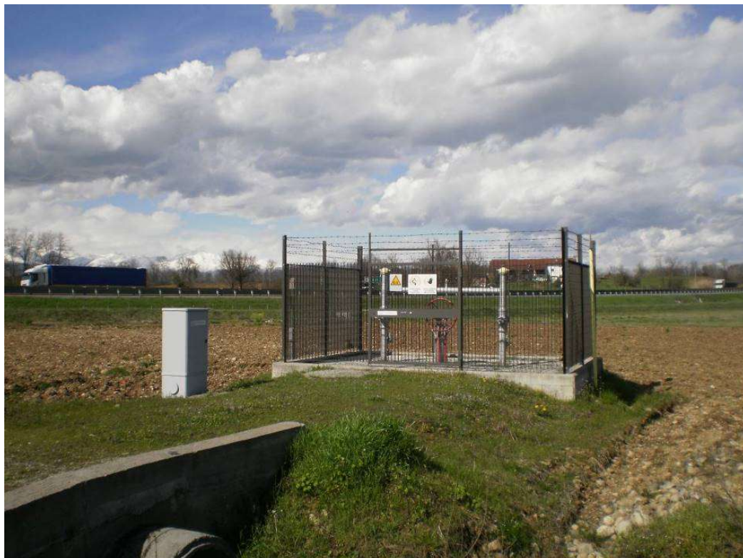
Fig. 4.1 – Esempio di impianto di intercettazione di linea PIL.
