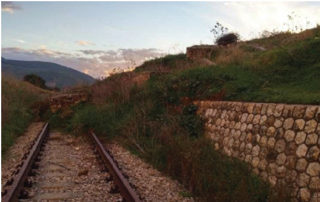
Figura 2-2 Tratto in trincea dissestato in corrispondenza del km 92+850
