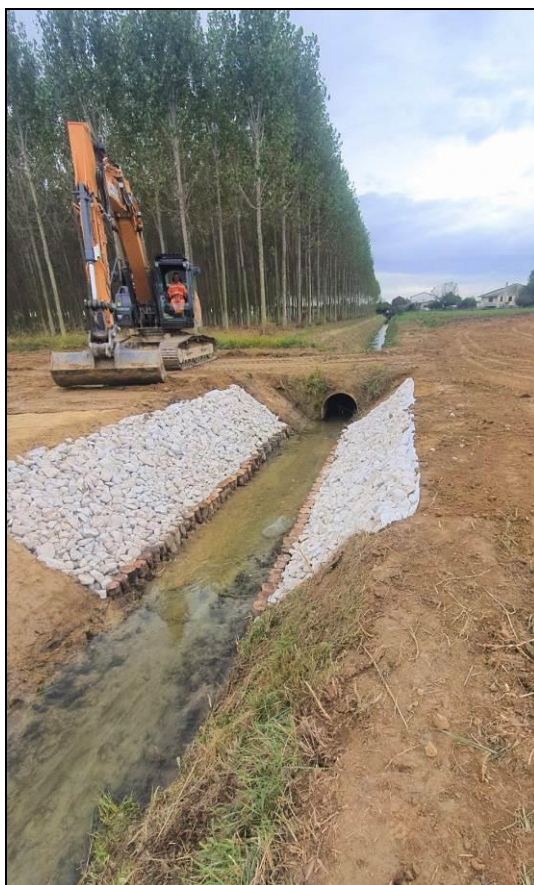
Figura 7.1: Esempio di un intervento in corso su uno dei fossi gestito dal Consorzio di Bonifica (Acque Risorgive)
