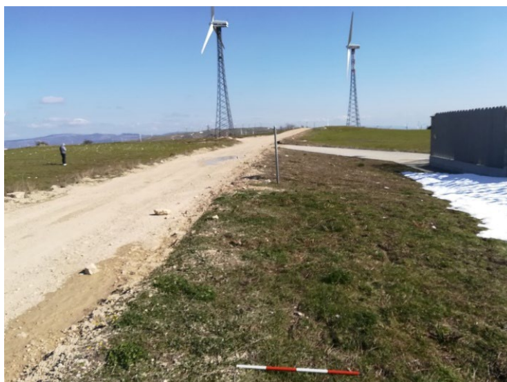
Foto 19-22 cavidotto lungo il declivio del colle all'incrocio con il tratto che porta alla sottostazione
