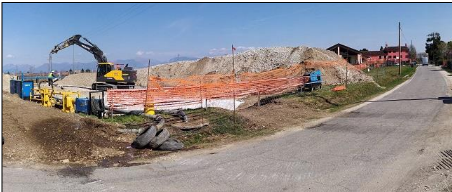
Figura Errore . Nel documento non esiste testo dello stile specificato..2/d Tipologie di barriere acustiche installate
