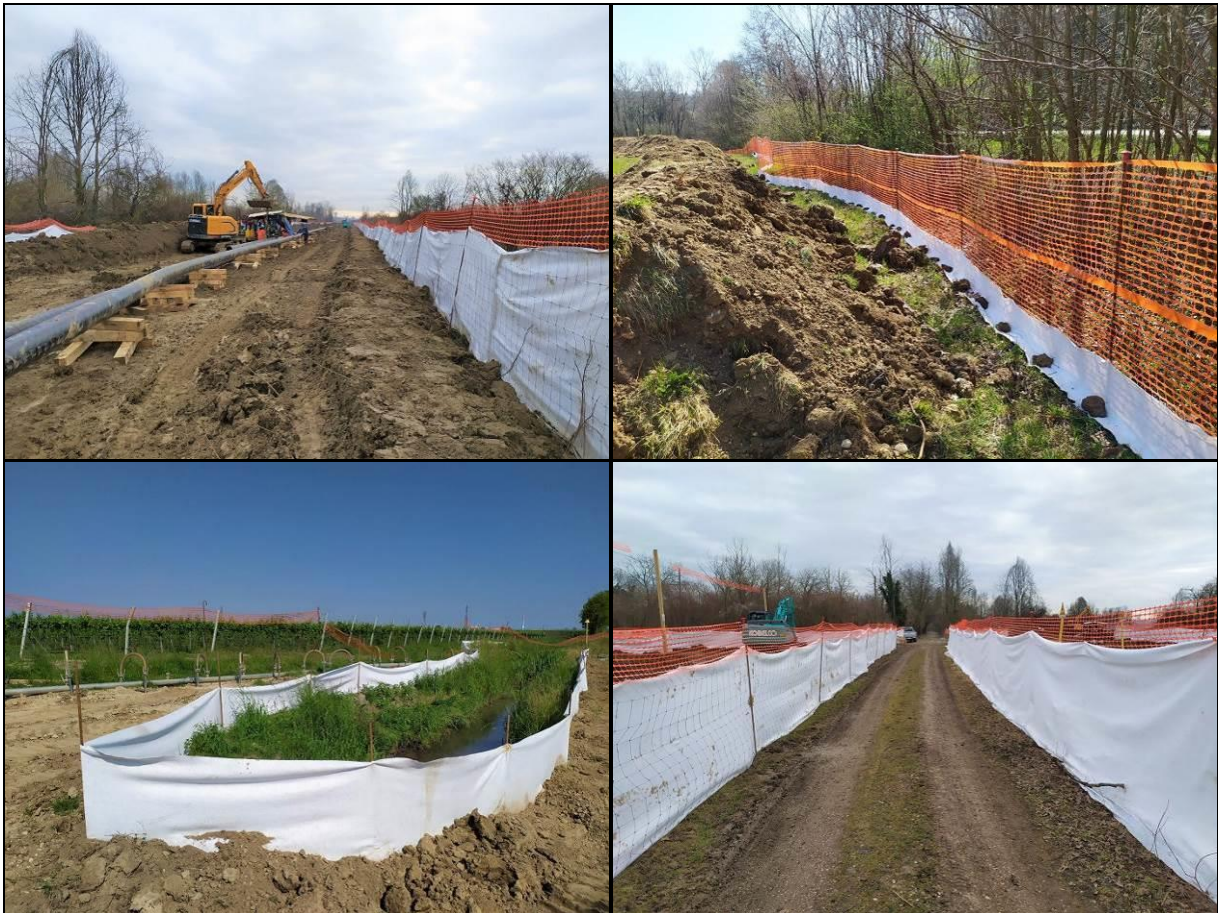
Figura Errore. Nel documento non esiste testo dello stile specificato.-4: Esempi di barriere anti-intrusione per l'erpeto fauna installate.
