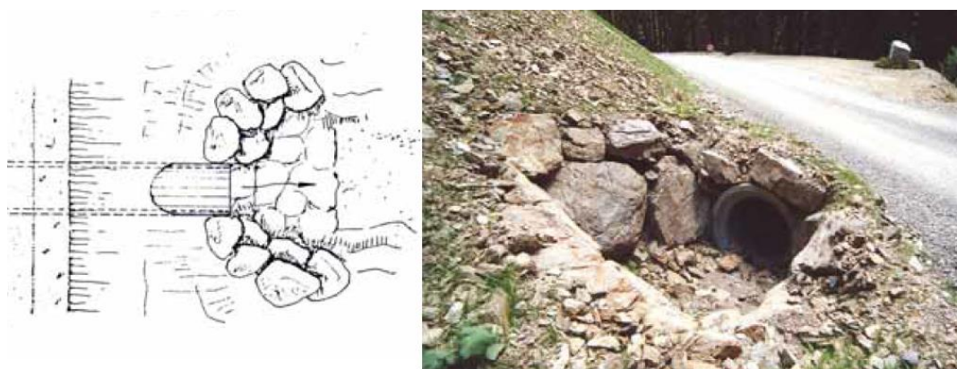
Figura 6.14: Pozzetti in legname e in massi (fonte: "Viabilità forestale regionale" Bortoli, P.L. 2001).
