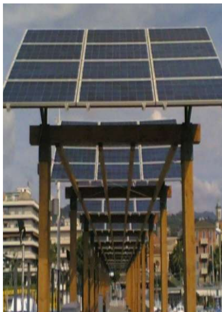
Figura 5-5 Esempio di pensiline fotovoltaiche
