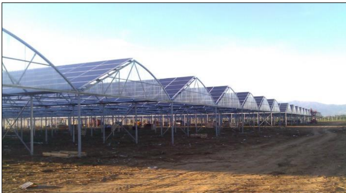
Figura 22 impianto posizionato su serra
