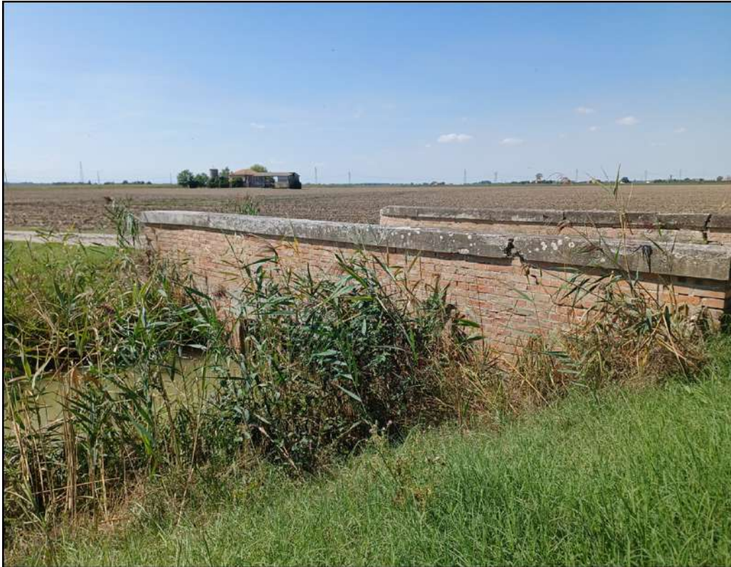
Ponte non idoneo lato nord
