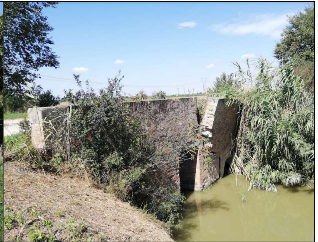
Ponte non idoneo lato nord
