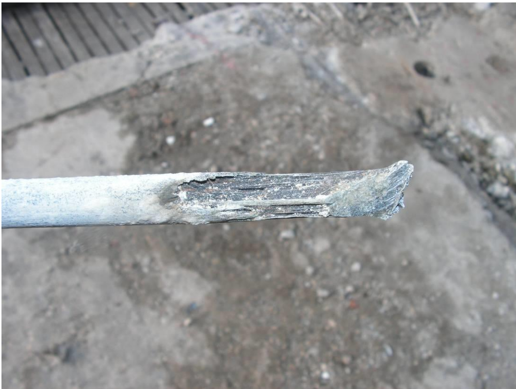
Corrosione localizzata delle armature per presenza di cloruri (pitting).
