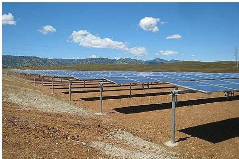
Figura 3.1-3 Inseguitori di Rollio
