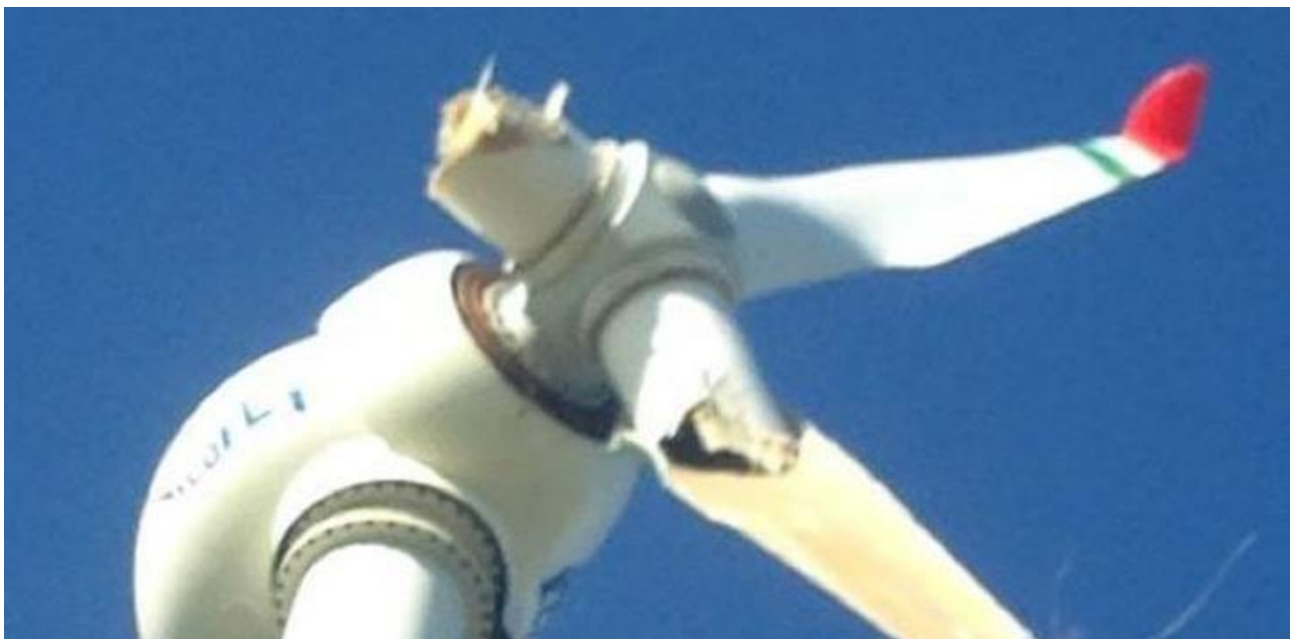
Figura 5- Esempio di rottura alla radice
