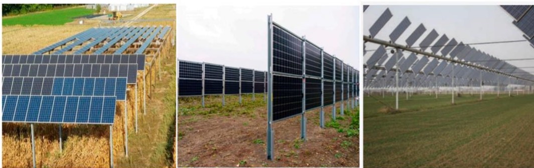
Figura 3. Esempi di differenti soluzioni agrivoltaiche: impianti fissi (Legambiente, 2020); moduli verticali; sistemi di inseguimento (Toledo e Scognamiglio, 2021); Sistema Agrovoltaico® ( https://remtec.energy/agrovoltaico )
