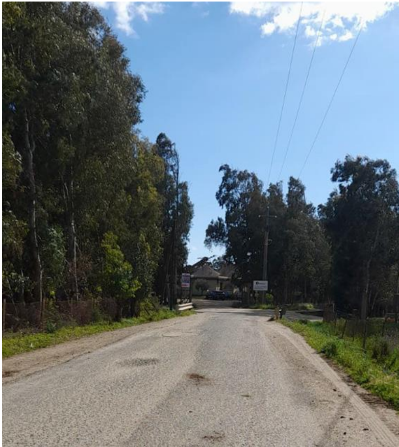
Figura 5: Restringimento strada a 4,7 m
