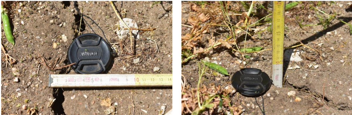
Figura 35 – Dettaglio di una fessurazione superficiali riscontrata all'interno del sito
