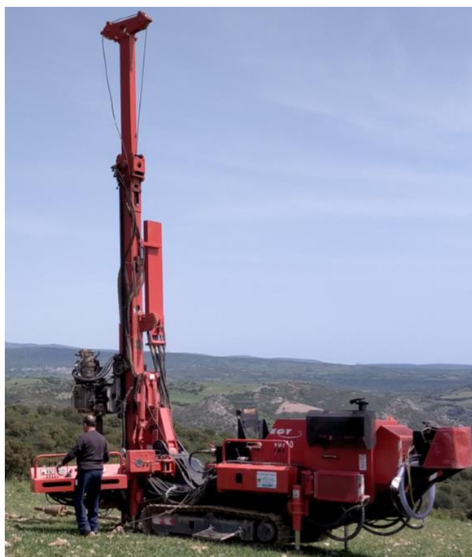
Figura 16 Sonda idraulica EGT VD710
