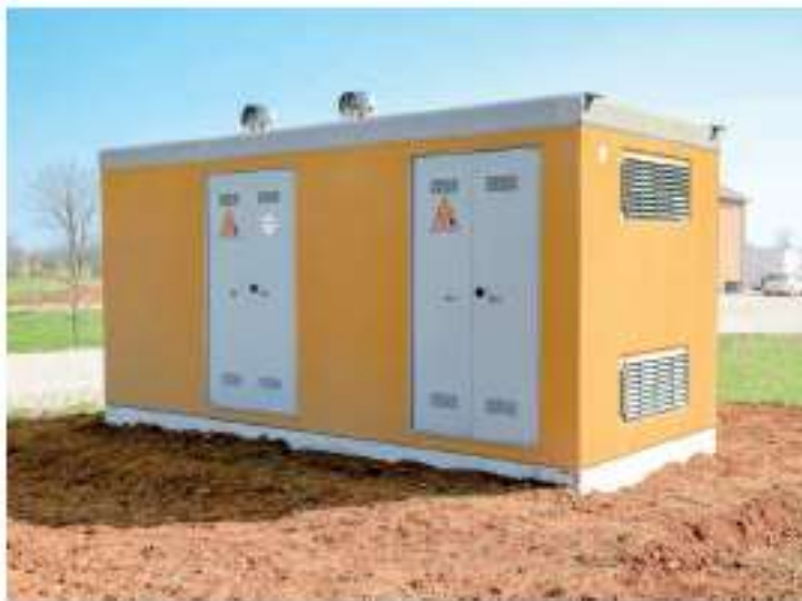
Figura 5.1 Vista Cabina quadri AT
