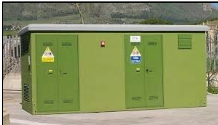
FIGURA 10 - CABINA ELETTRICA MONOLITICA IN RAL6002
