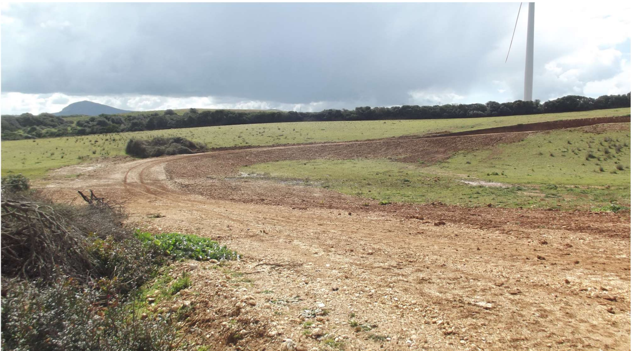
Strada di servizio realizzata per l'installazione delle turbine eoliche e che ospiterà il cavidotto
