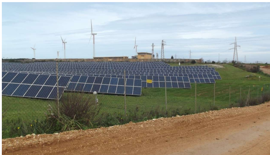
Area non accessibile (4.3 O) con impianto fotovoltaico
