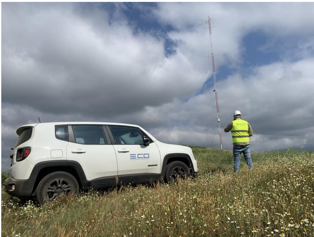
Figura 15 - Foto torre di misura anemometrica installata
