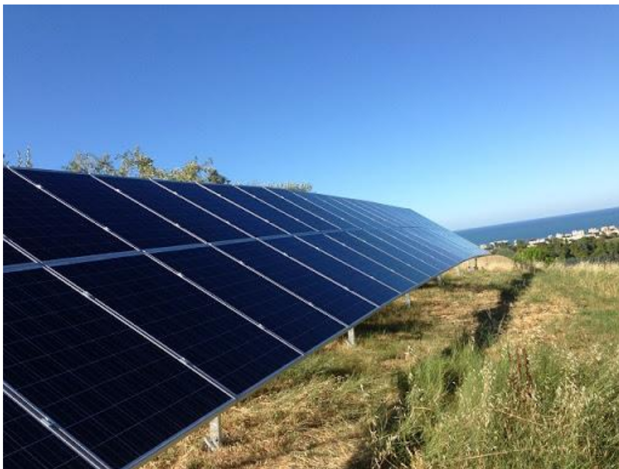
Figura 4.10: Esempio di Struttura di sostegno moduli fotovoltaici
