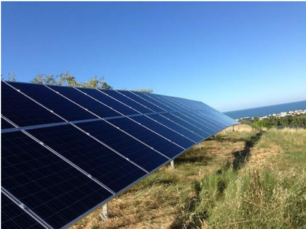
Figura 3.10: Esempio di Struttura di sostegno moduli fotovoltaici
