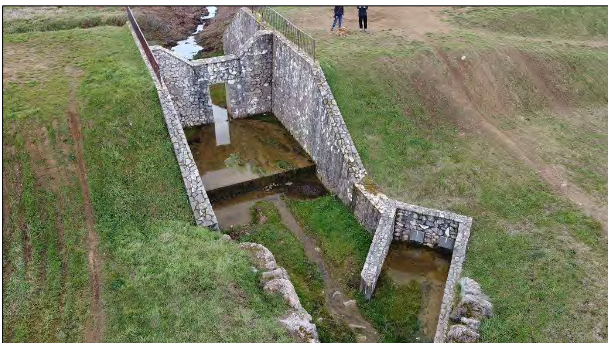
Figura 2.13: Sopralluogo nell'area di ubicazione dell'impianto, posizione 3: dettaglio dell'opera di regolazione in linea delle portate e degli scarichi di fondo con valvole a 'clapet' di non ritorno, vista da valle verso monte, scatto aereo da drone
