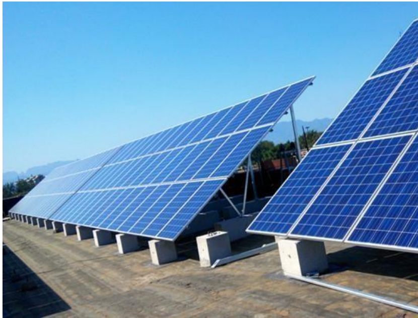
Figura 7. Esempio di impianto fotovoltaico con fondazioni formate da zavorre costituite da plinti in cemento
