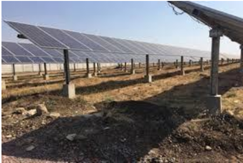
Figura 5. Esempio di impianto fotovoltaico con fondazioni ottenute mediante perforazione del terreno e successiva creazione del palo
