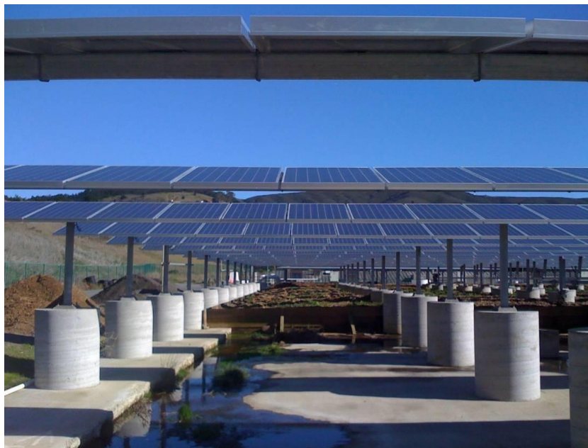
Figura 6. Esempio di impianto fotovoltaico con fondazioni formate da zavorre costituite da plinti in cemento
