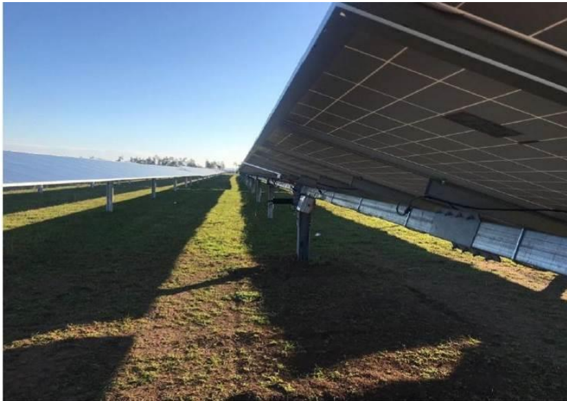
Figura 3. Esempio di impianto fotovoltaico realizzato con supporti costituiti da pali in acciaio infissi direttamente nel terreno. Gli impatti sul suolo sottostante risultano essere minimizzati.
